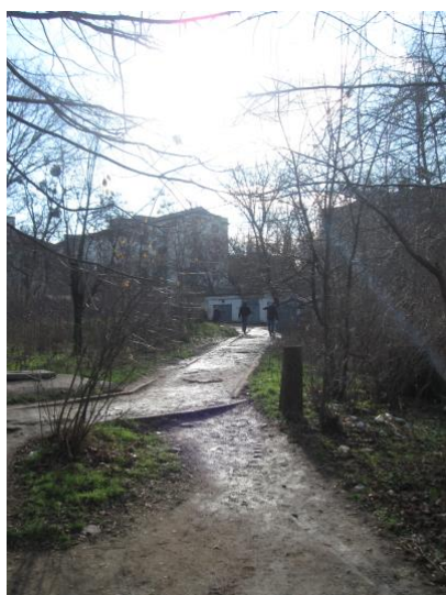
Фото 1. Некачественное дорожное покрытие
